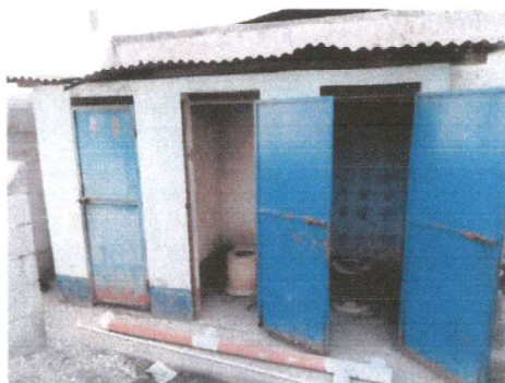
Foto 3: PUERTAS EN MAL ESTADO
