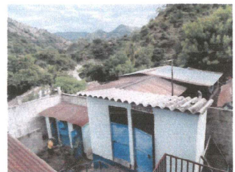
Foto 5: TECHO EN MAL ESTADO AREA DESANITARIOS
