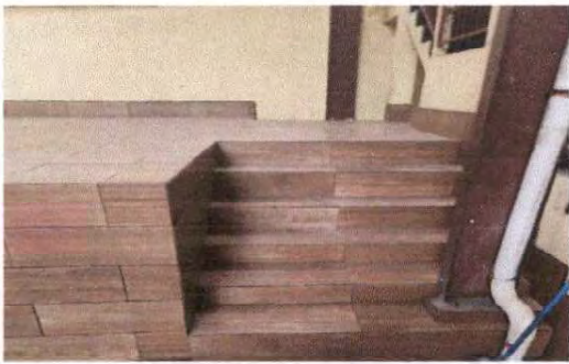
Foto 3: Piso de gradas instalado y en buen estado
