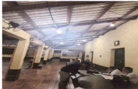
Foto 2: Lamparas Led colocadas
