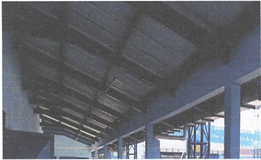
Foto 4: se colocó laminas en doinde había fugas.
