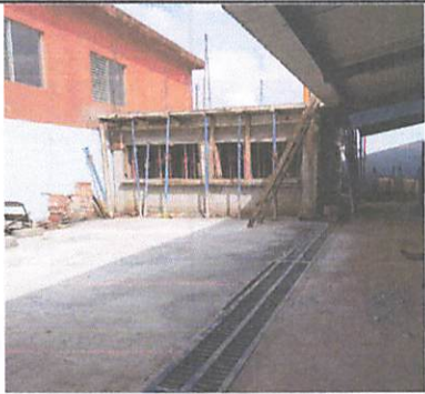
Foto 3: Secado de losa en bodega de cocina.
