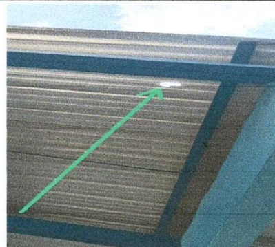
Foto 4: Laminas con agujeros y entra agua en cocina
