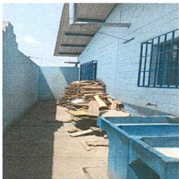
Foto 1: MURO PERIMETRAL EN MALAS CONDICIONES
