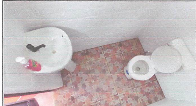
Foto 4: Lavamanos y sanitarios en el mismo espacio.
