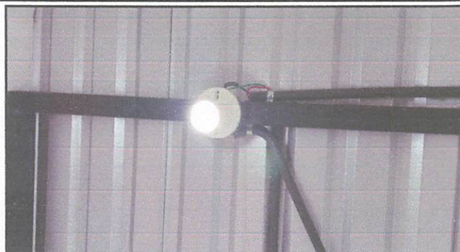
Foto 1: Energía eléctrica en cada sanitario.
