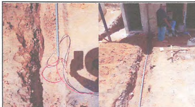
Foto 3: introducción subterránea de la energía eléctrica.
