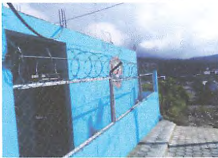
Foto 3: AREA PERIMETRAL CON ALAMBRE PUAS
