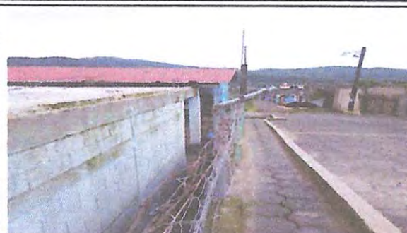
Foto 2 QUITAR ALAMBRE Y COLOCAR ALAMBRE DE PUAS
