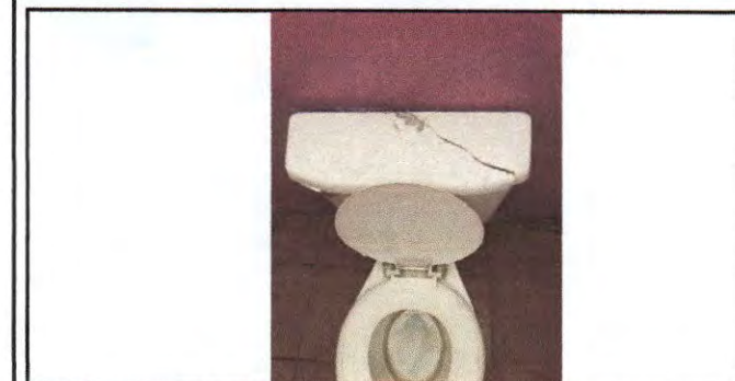
Sanitario quebrado y accesorios en mal estado
