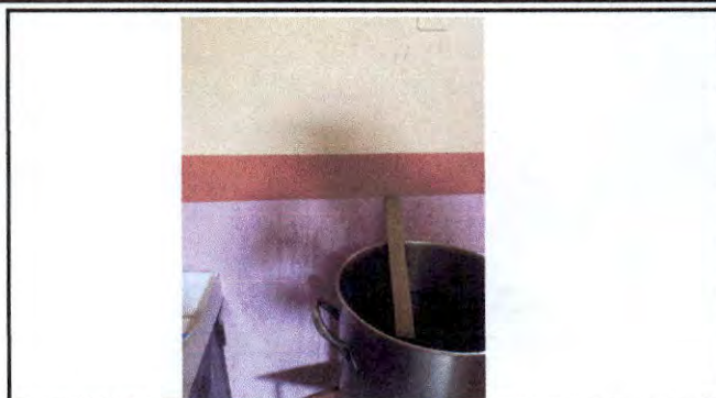
Pared de la cocina sin azulejo
