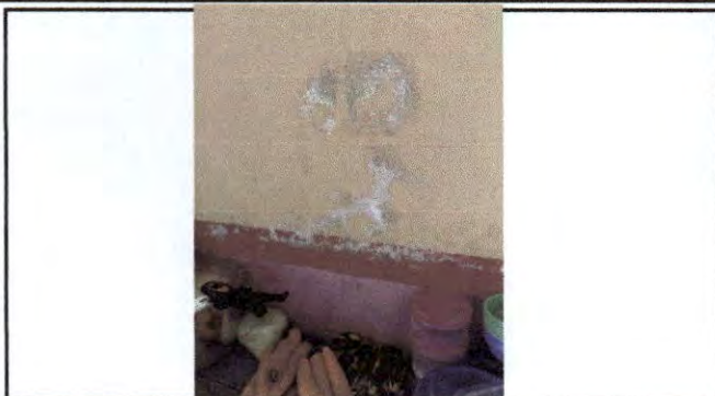
pared de la cocina sin azulejo
