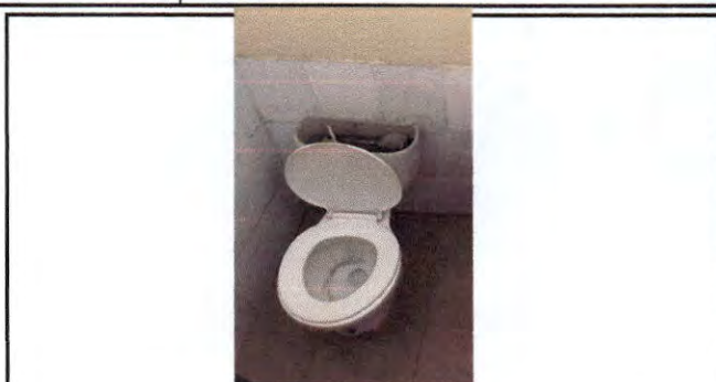
Sanitario de niñas Sin tapadera, drenaje y accesorios en mal estado
