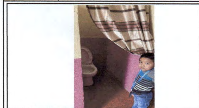
Sanitario con drenaje en mal estado y sin puerta
