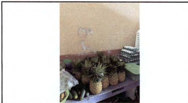
Pared de la cocina sin azulejo
