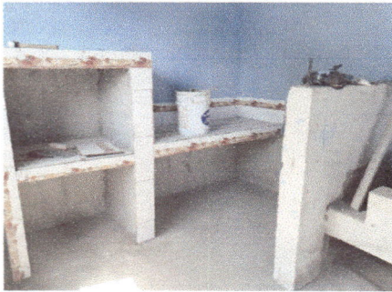
Foto1: Parte interna de la cocina, remodelar gabinete, mesa de azulejo y piso cerámico
