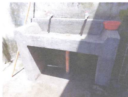
Foto 2: repello de lavamanos .
