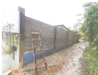
Foto 4: repello de pared perimetral.
