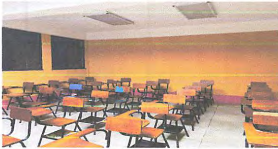
Foto 7: pintura en paredes en el interior de salones
