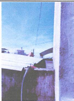
FOTO1: BAJADAS DE AGUA
