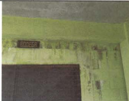
Foto 6: se requiere impermeabilizar dos salones de clases.
