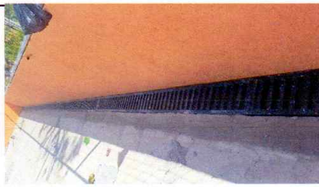
Foto 4: Rejilla de tragante de agua pluvial instalada
