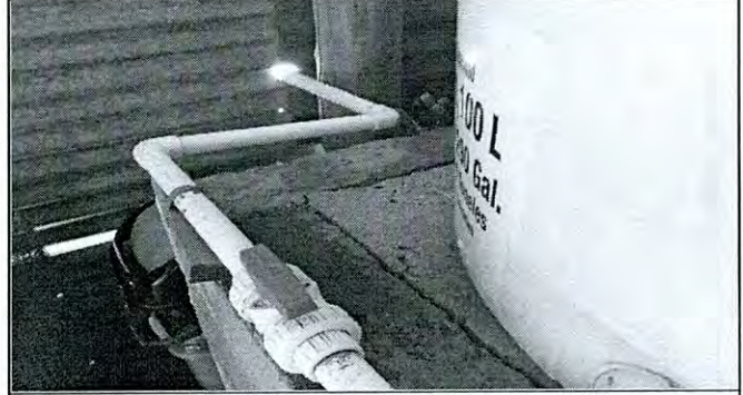
Foto 2: El peso del tinaco esta deteoriando la plancha en la que se encuentra
