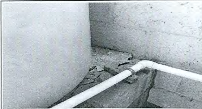
Foto1: El peso del tinaco esta deteoriando la plancha en la que se encuentra
