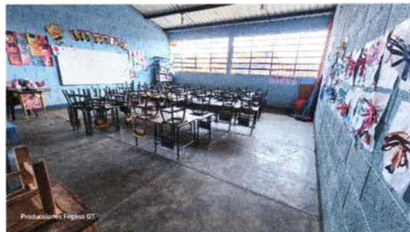
piso de aula a levantar y sustituir por cerámico
