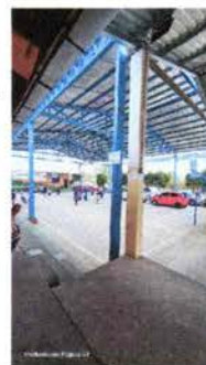
Columna 2 de cancha a sustituir
