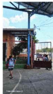
Columna 4 de cancha a sustituir
