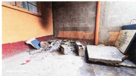
Estufa improvisada de cocina y se sustituirá
