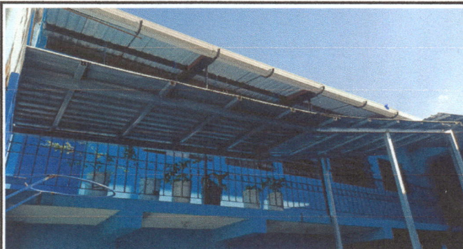
Foto 5: TECHADO DE GRADAS QUE SE ENCUENTRAN A LA INTERPERIE.
