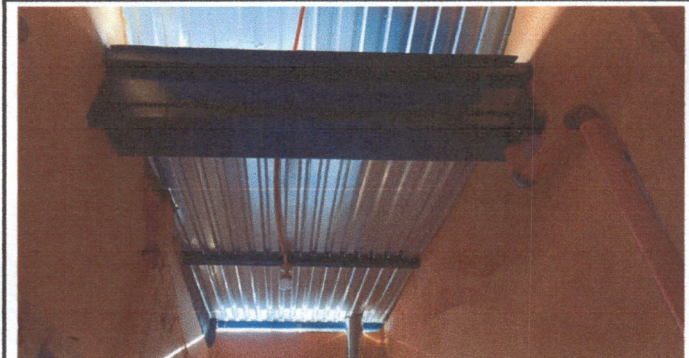
Foto 4: TECHO EN MAL ESTADO, POCA ELEVACION PARA LA CIRCULACION DE HUMNO
