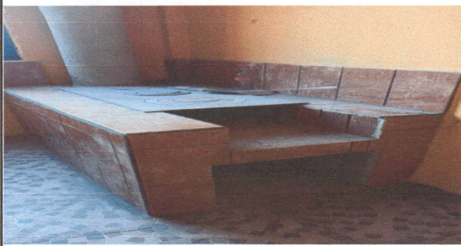
Foto 1: POLLETÓN EN MAL ESTADO
