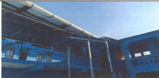
Foto 5: TECHADO DE GRADAS QUE SE ENCUENTRAN A LA INTERPERIE.
