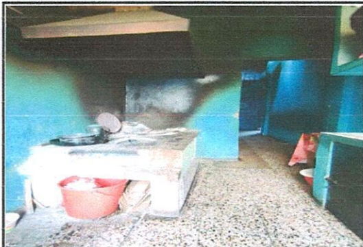
Foto 1: POLLETÓN EN MAL ESTADO
