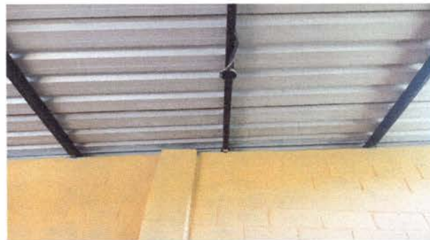
Foto 8: Se eliminaron los soportes de tubos (lamparas)
