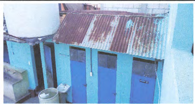
Foto 4: Tres sanitarios existentes únicamente.
