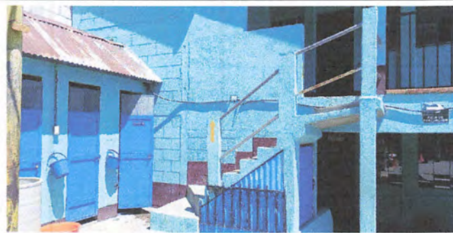
Foto 5: Cambio de red de drenaje de sanitarios, pila y cocina; buen porcentaje del existente va a un drenaje francés que está por colapsar.
