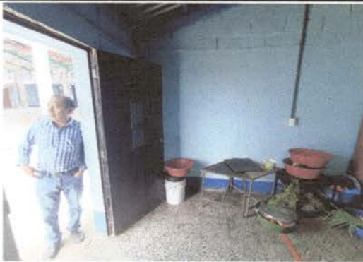
Foto 7: PUERTA DE METAL CON MARCAS DE CORROSIÓN
