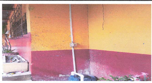
Foto 2: Lugar de bomba de cisterna
