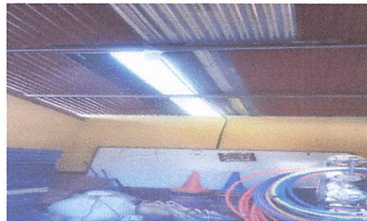
Foto 4: Por filtración de agua en la lamiluz se cambió por otra
