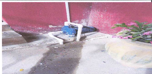
Foto 2: Lugar de la bomba de cisterna
