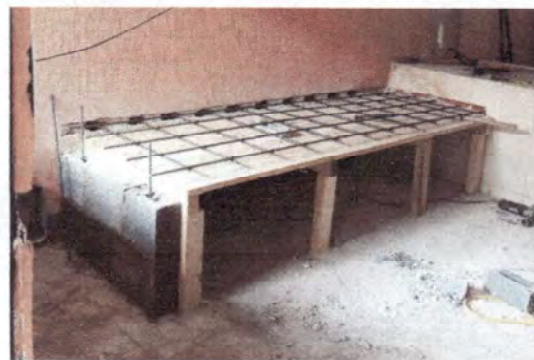
Foto 2: mesa de concreto en cocina
