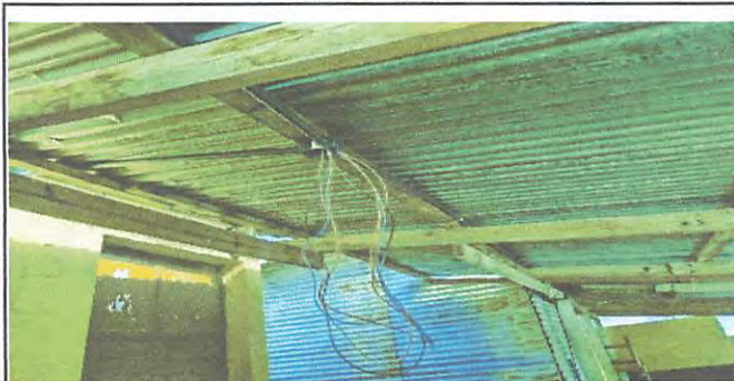
Foto 4: INSTALACION ELECTRICA NUEVA
