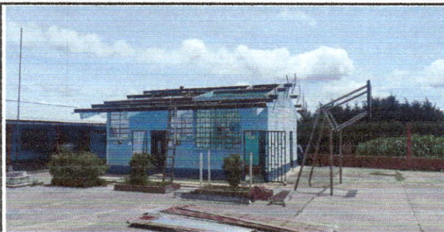
Foto 1: DESINSTALACION DELTECHO DEL MODULO I, SANITARIOS Y DIRECCION EN MAL ESTADO
