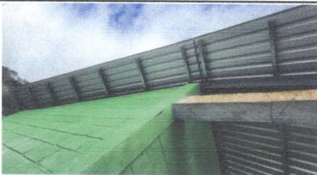
Foto 5: Cambio de capote para no tener filtraciones.
