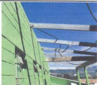
Foto 5: Cambio de capote para no tener filtraciones.
