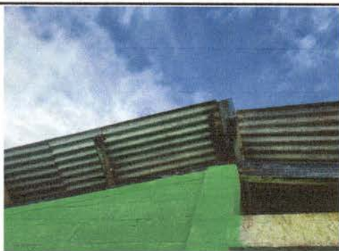
Foto 5: Cambio de capote para no tener filtraciones.
