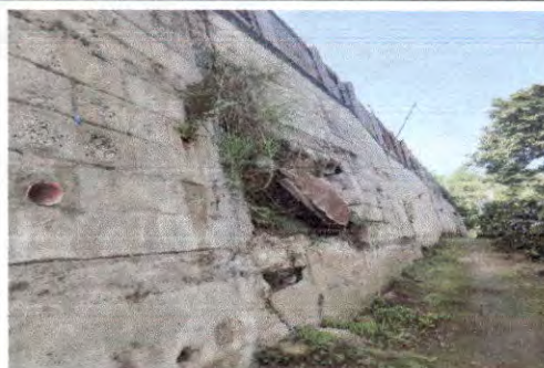
Foto 2: Muro de contención en mal estado
