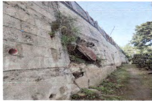
Foto 2: Muro de contención en mal estado
