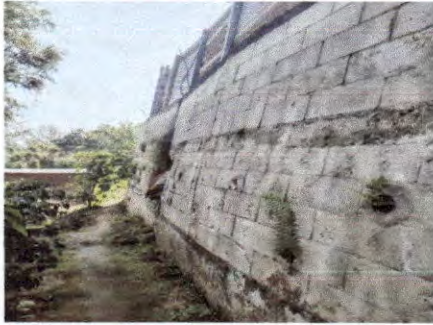
Foto 1: Muro de contención en mal estado
