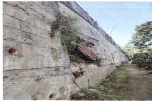
Foto 2: Muro de contención en mal estado
