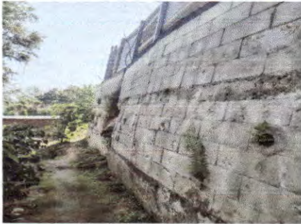
Foto 1: Muro de contención en mal estado
