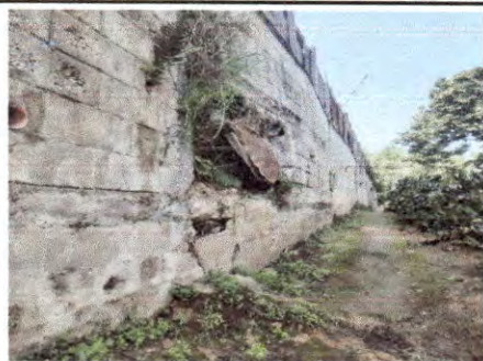
Foto 3: Muro de contención en mal estado
