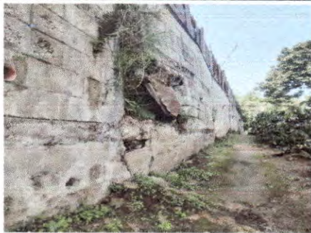
Foto 3: Muro de contención en mal estado
