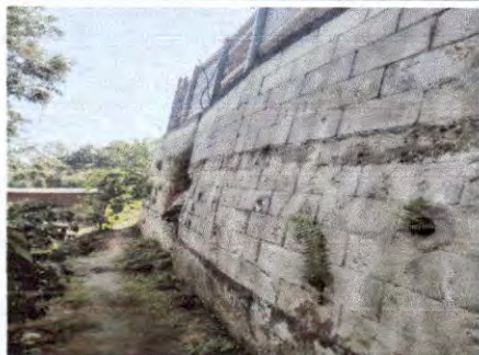
Foto 1: Muro de contención en mal estado
