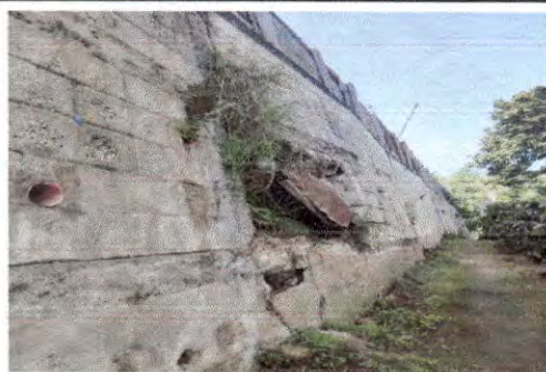
Foto 2: Muro de contención en mal estado
