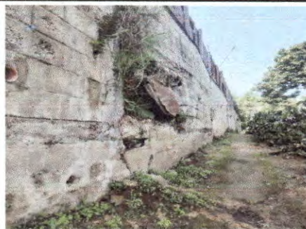
Foto 3: Muro de contención en mal estado
