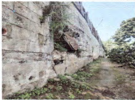
Foto 3: Muro de contención en mal estado
