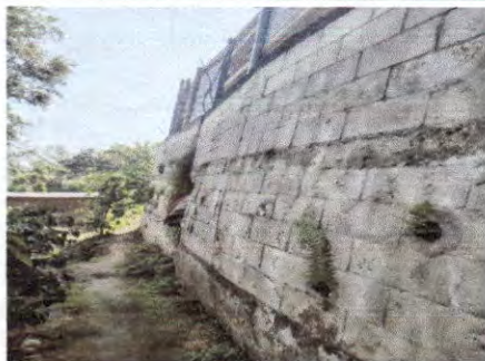
Foto 1: Muro de contención en mal estado
