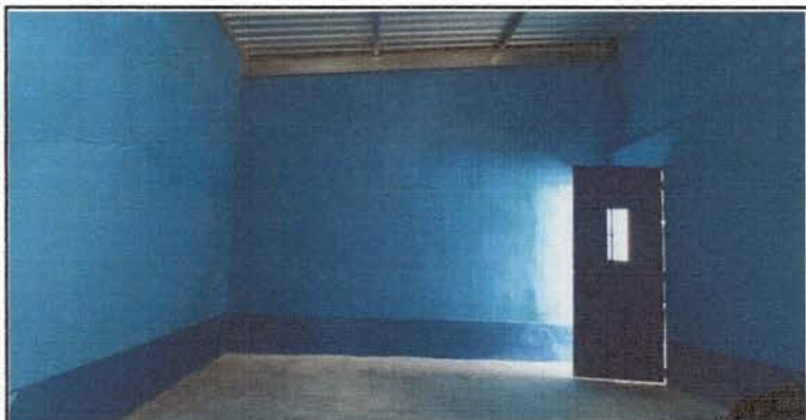
Foto 3: Paredes interiores y techo interior.
