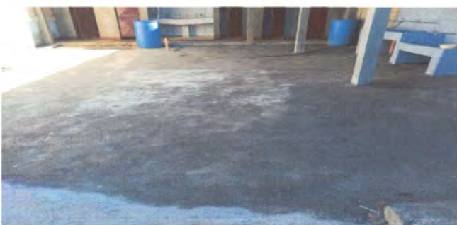
Foto 5: pavimento en frente de sanitarios -abajo
