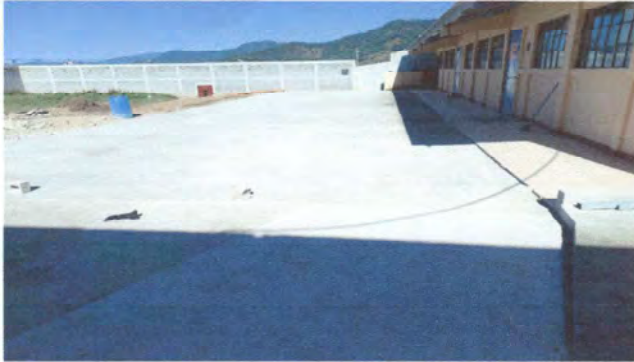
Foto1: pavimento frente a las aulas
