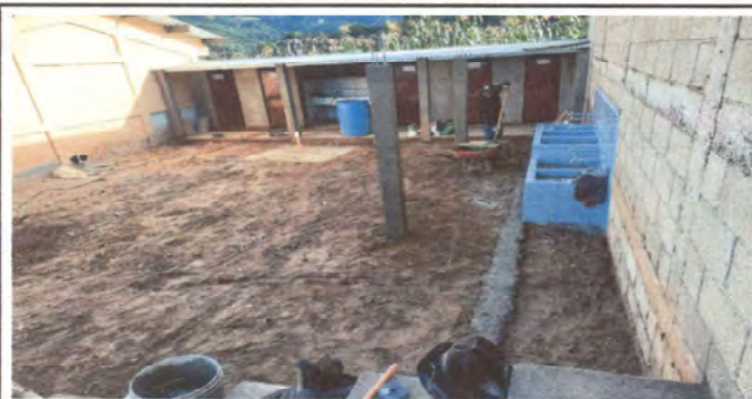
Foto 5: pavimento en frente de sanitarios -abajo
