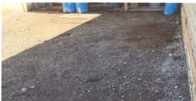
Foto 5: pavimento en frente de sanitarios -abajo
