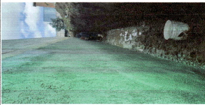
Foto 7: Cernido parte baja de pared trasera de las aulas
