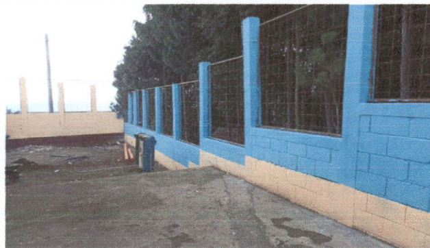
Foto 2: Pintura en paredes de la circulación del establecimiento
