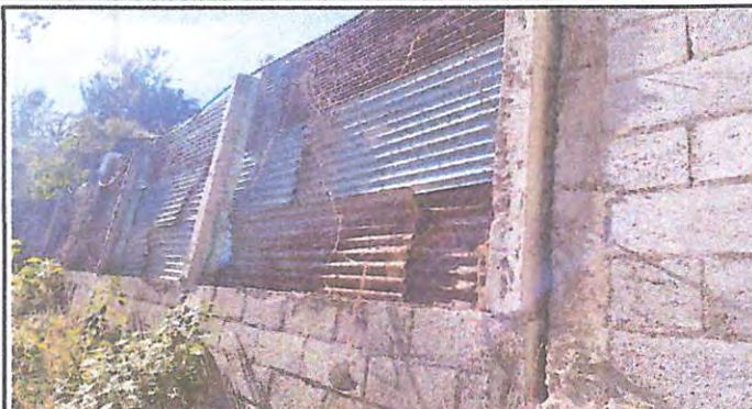
Foto1: Muro perimetral con deterioro total.
