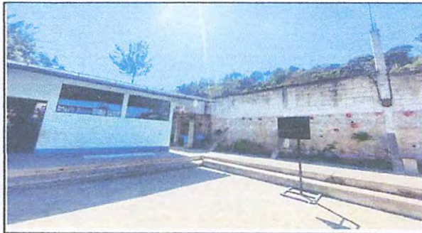
Foto 2: Paredes exteriores e interiores deterioradas.
