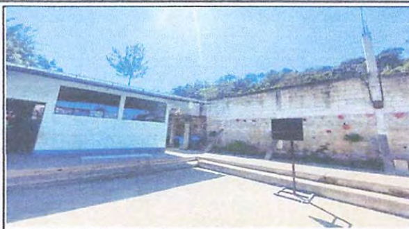
Foto 2: Paredes exteriores e interiores deterioradas.
