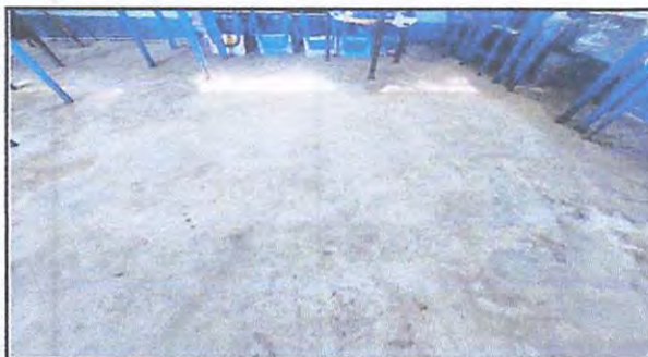
Foto 3: Piso de un salon totalmente en deteriorado.
