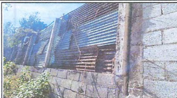
Foto 1: Muro perimetral con deterioro total.
