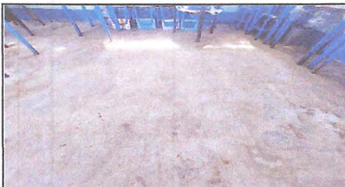
Foto 3: Piso de un salon totalmente en deteriorado.
