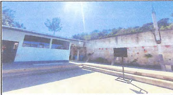
Foto 2: Paredes exteriores e interiores deterioradas.
