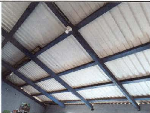
Foto 1: Remiendos en la estructura de madera y aparición de termitas.
