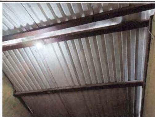
Foto 3: Deterioro y pudrición por la humedad.
