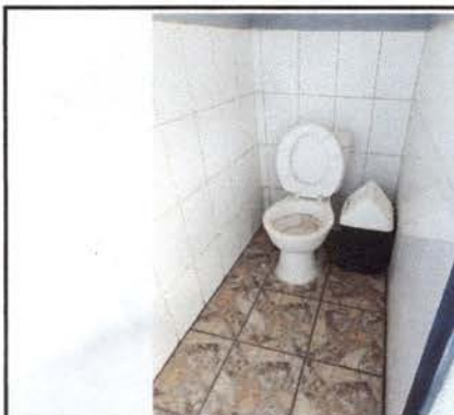
Foto 7: Deterioro de loza sanitaria.
