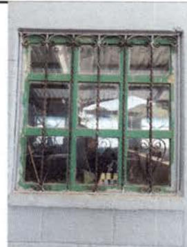
Foto 6: Deterioro de los balcones de metal.
