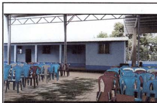
Foto 10: Falta de canales y salidas de agua.
