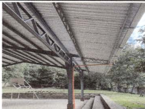
Foto 2: vista actual del polideportivo, en donde se nota que es corto el techado. Después del remozamiento
