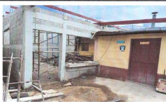
Foto 6: Hace falta la colocación de techo
