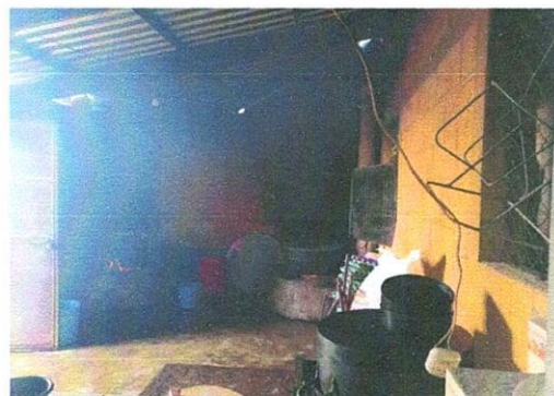
Foto 4: ES NECESARIO INSTALACIÓN ELÉCTRICA DENTRO DE COCINA (ILUMINACIÓN).
