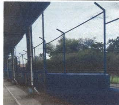
Foto 4: SE NECESITA CAMBIO DE MALLA PERIMETRAL + ALAMBRE ESPIGADA, ASI COMO EL MANTENIMIENTO DE TUBOS EXISTENTES.
