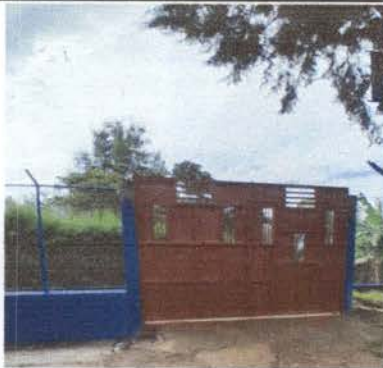
Foto 3: PORTON EN MAL ESTADO, CAMBIAR PORTON DE METAL POR PORTON DE METAL.
