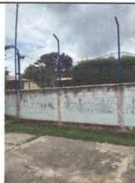
Foto 4: SE NECESITA CAMBIO DE MALLA PERIMETRAL + ALAMBRE ESPIGADA, ASÍ COMO EL MANTENIMIENTO DE TUBOS EXISTENTES.
