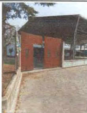
Foto 3: PORTON EN MAL ESTADO, CAMBIAR PORTON DE METAL POR PORTON DE METAL.
