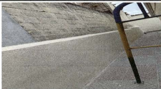
Foto 2: filtraión, piso en patio
