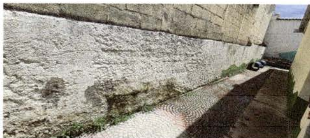
Foto 3: filtración, piso en patio, cisterna
