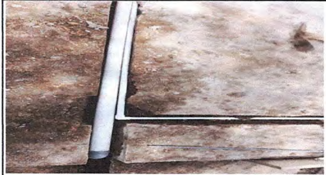
Conexión de drenaje y agua potable para la cocina.
