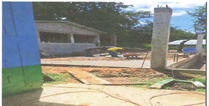
Foto 6: TORTA DE CONCRETO
